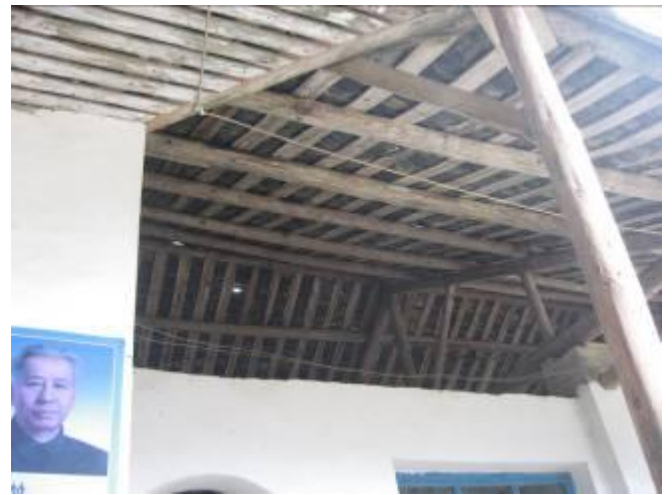
校舍屋頂洞穿，雨天漏雨
