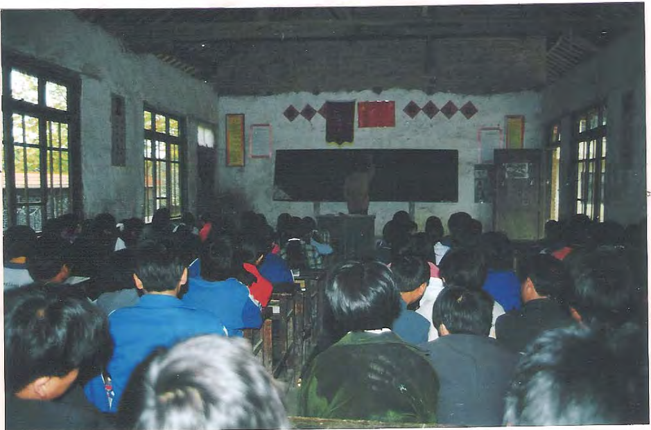
图五：斑驳破损的墙面，倾斜将塌的墙体，依然在艰难的为学生遮雨挡寒，但那老态似乎暗示人们，自己早已不堪重负。
