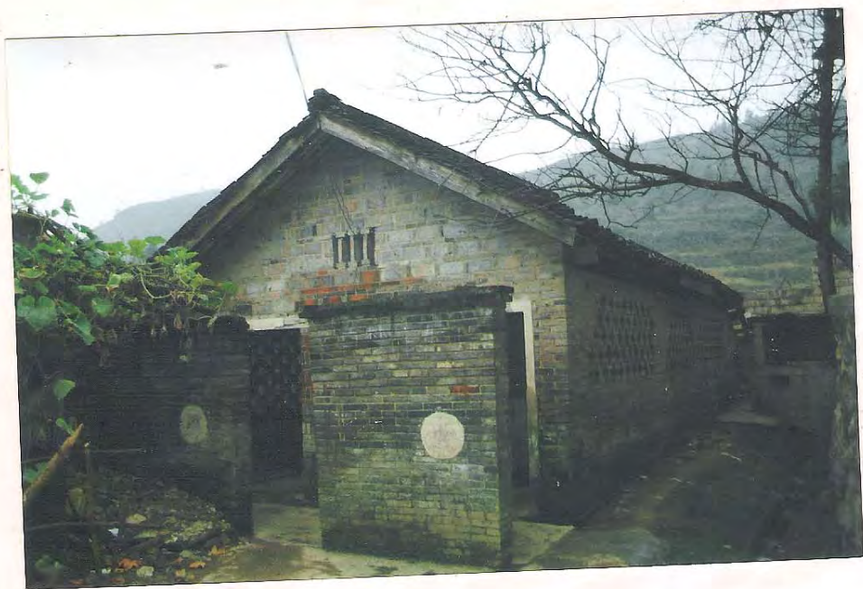
图六：七百余人的学校，厕所居然只有二十余个蹲位，何况墙体已多处裂缝下陷，不仅如此，六百余名住校生容身在 16 间面积不足 350 平方米的房间里住寝，其窘境可见一斑。
